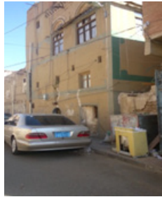
شكل رقم (35): جمال مواد البناء وعدم انسجام أشكال النوافذ وظهور التمديدات على الواجهة (C7)
