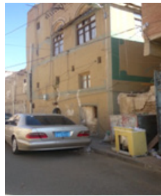
شكل رقم (35): جمال مواد البناء وعدم انسجام أشكال النوافذ وظهور التمديدات على الواجهة (C7)
